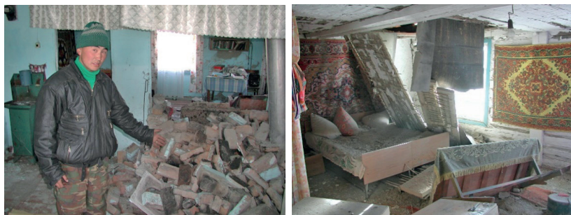
Разрушение домовых печей и жилья в пос. Бельтир Кош-Агачского района Республики Алтай
