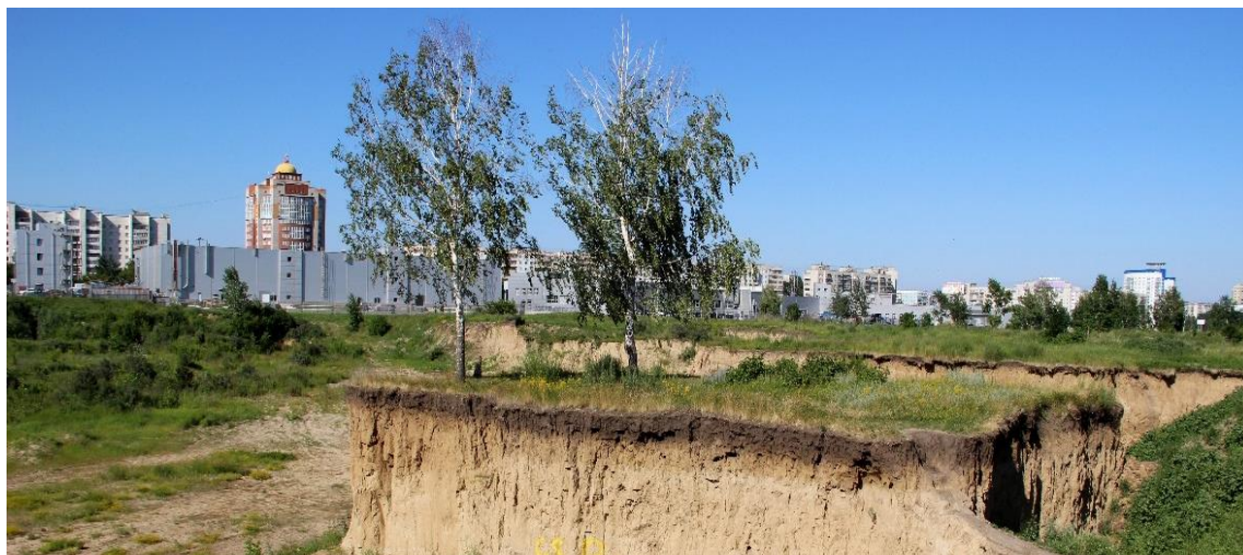
Рисунок 2.3.2. – Фотофиксация обрыва на объекте проектирования (фото автора)
