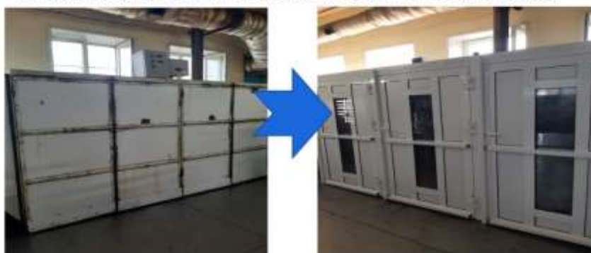
Замена расстойных шкафов. Сокращение времени расстойки на 10 минут с одного теста
